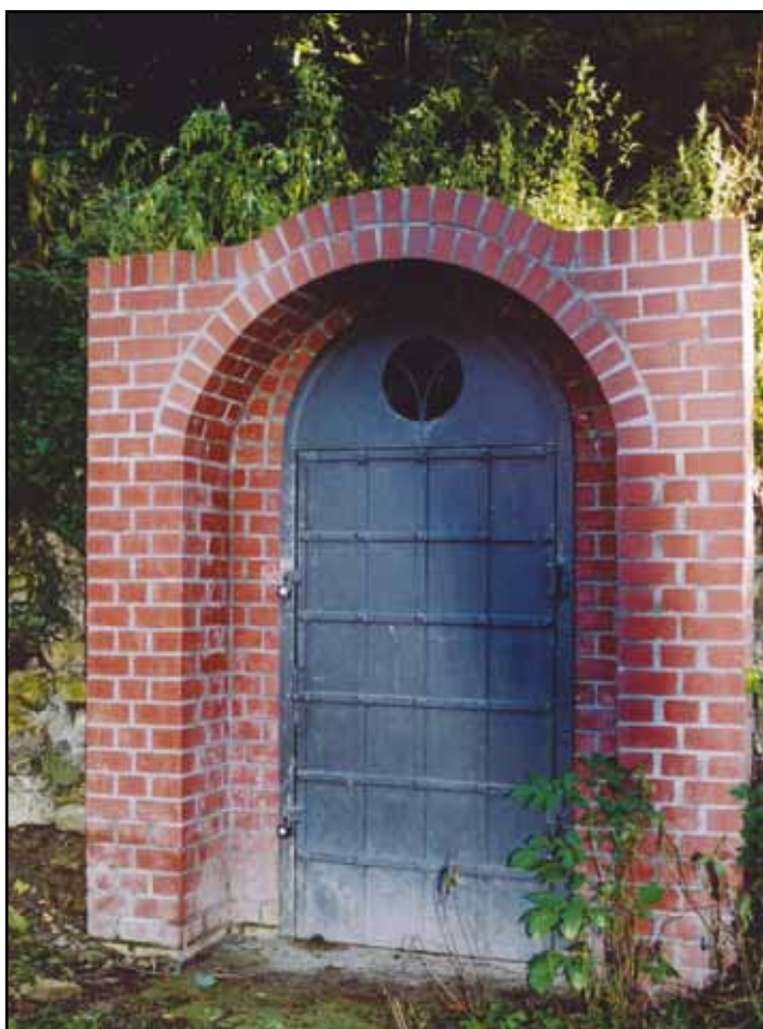
Jímací štola Chaloupka v ulici Pod Novým lesem upravená pro současné čerpání užitkové vody pro Hrad
