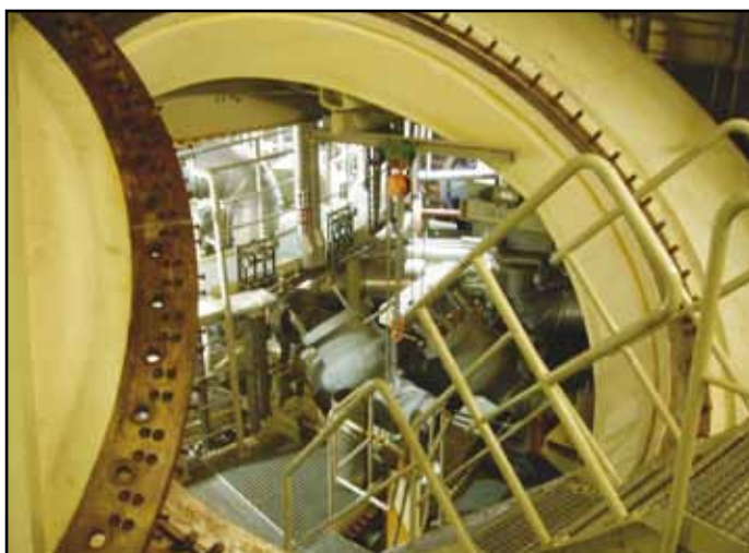
Vstup do kontejnmentu elektrárny Zwentendorf
