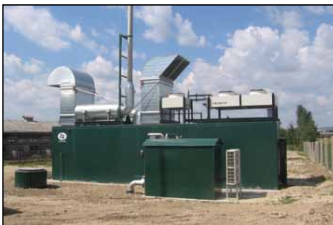
Kogenerační jednotka bioplynové stanice Dřevce
