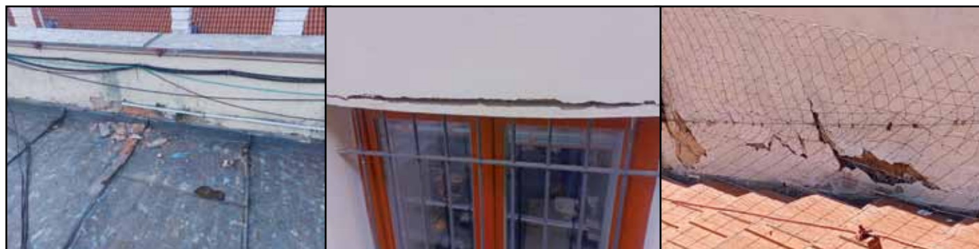
Poškozená fasáda NL
