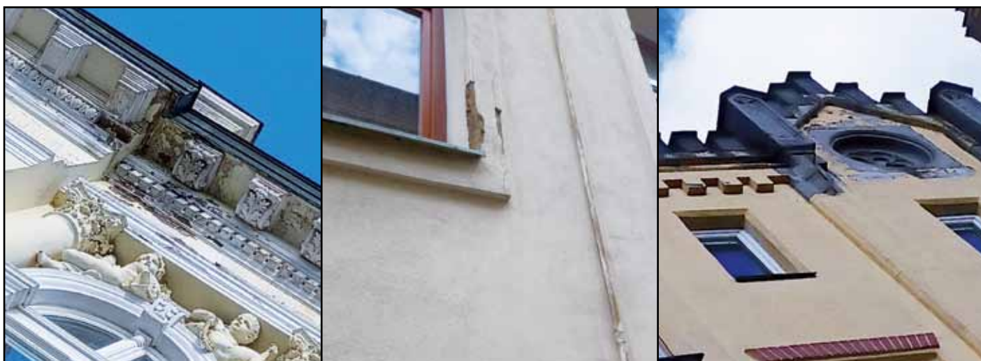
Poškozená fasáda NL
