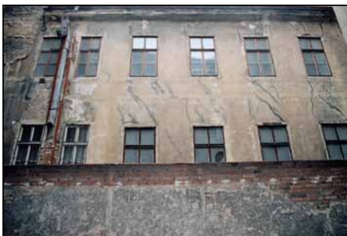
Činžovní dům na Praze 5 s poškozeným okapovým svodem
