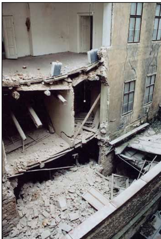
Kolaps obvodové zdi v důsledku fatálních změn v zemině pod základy
