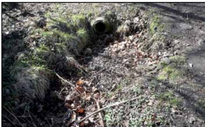
Zde se již voda vsakuje do země
