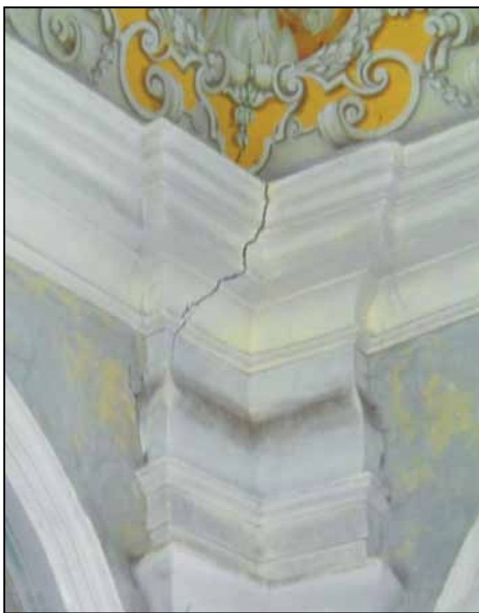
Obrázek 6. Trhlina jako důsledek nerovnoměrného sedání základů kostela Všech svatých v Heřmánkovicích
