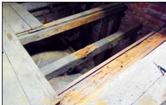
Obrázek 4. Stropní trámy poničené působením tesaříka, kostel sv. Anny ve Vižňově
