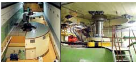
Generátory ... a pohled na část turbíny pod generátorem.
