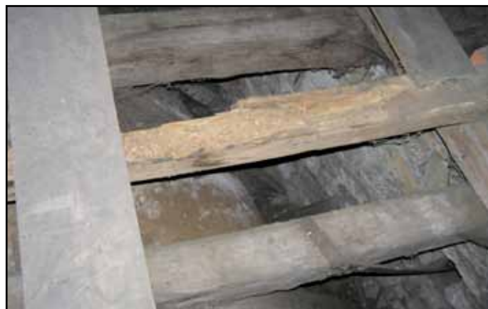
Obrázek 3. Stropní trám zničený působením tesaříka, kostel sv. Barbory v Otovicích
