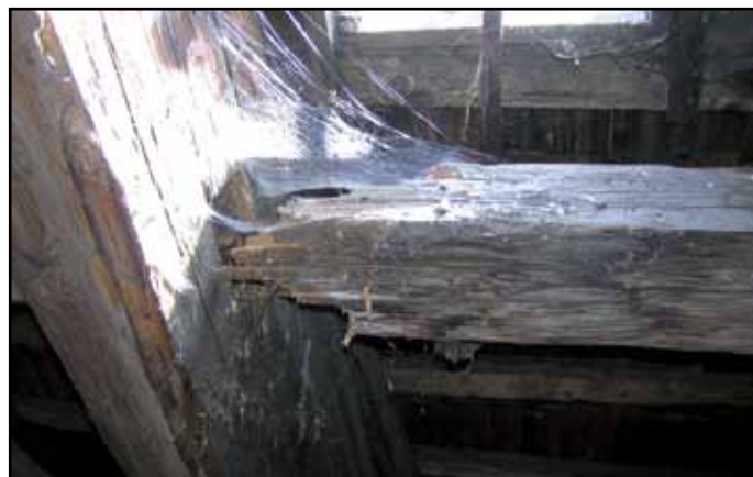
Obrázek 2. Detail „uhnutí“ vaznice vlivem trámovky, kostel sv. Barbory v Otovicích
