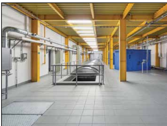
Třetí stupeň úpravy vody – „uhlíkové filtry“; ovládání technologie přes displej PC systému
